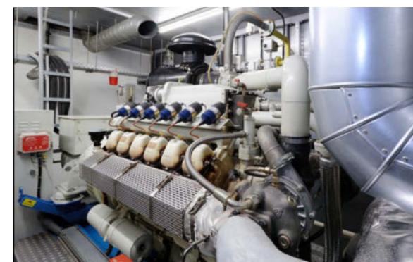
Ressourcenschonung soweit das Auge reicht: Windkraftanlagen (großes Bild links), Photovoltaikanlagen, Kältemaschine und Blockheizkraftwerk (kleine Bilder von oben).
