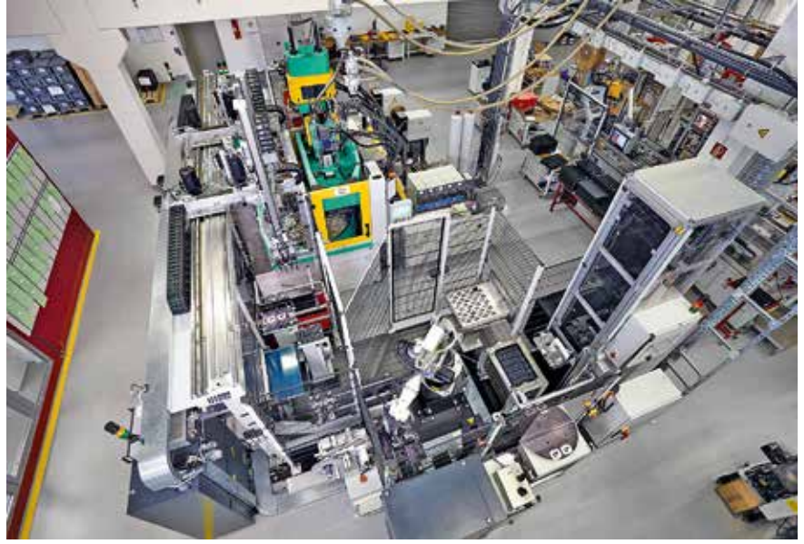
Bild 7. H&B Electronic setzt auf eine komplexe Turnkey-Anlage. Die Handhabung übernehmen drei Sechssachsroboter sowie zwei auf einer Traverse verfahrenende Linearroboter. Die Kommunikation läuft komplett über die zentrale Maschinensteuerung
